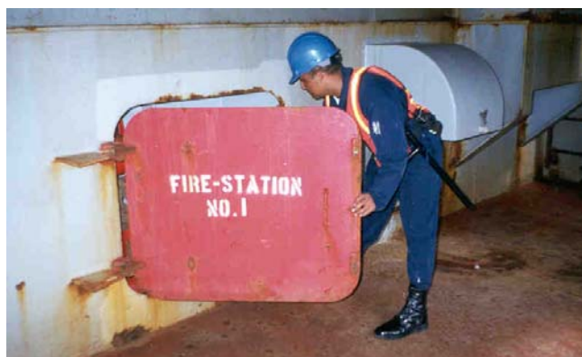
Foto 15.14. – Inspecciona el interior de las cajas de mangueras, áreas de bodegaje y grúas
